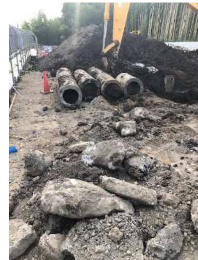
④建設工事中の地中障害物
