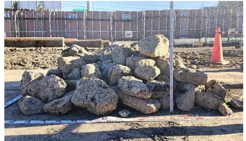
②杭打ち箇所の地中障害物
