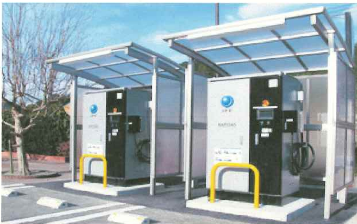
・急速充電設備の外観
