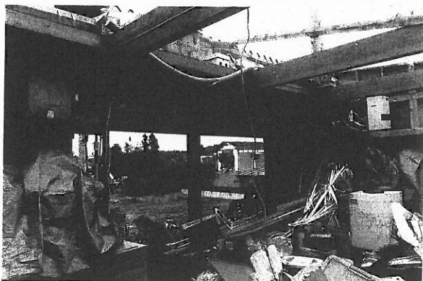
台風19号の竜巻被害にあった住宅（千葉県市原市）。流山市議団は10月17日、流山市へ台風対策の要請書を提出しました。
