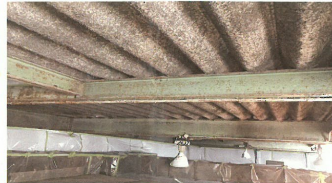
S51年焼却施設3工区吹付石綿 除去前状況
